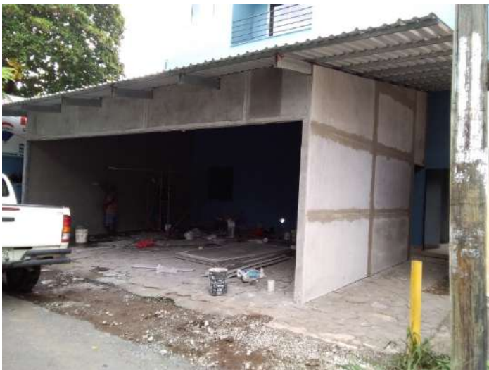
Clausura de una construcción irregular carente de permisos
